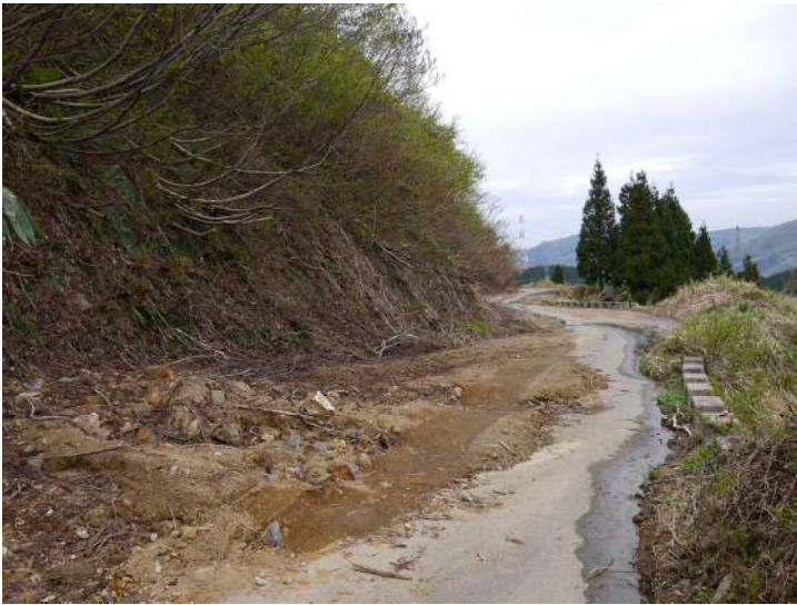
土砂くずれで、通行止めの山道
